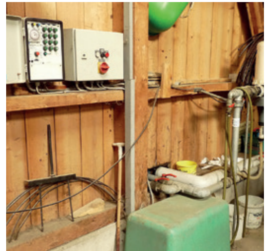
Kleiner Kasten, grosse Wirkung – Bewässerung aus der Scheune.
