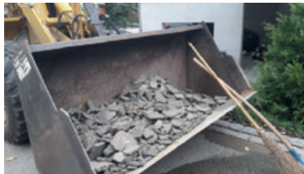
Kalk aus ca. 50m Meteorwasserleitung herausgeholt «Im Püntli».
